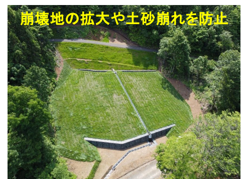
R3.8月の大雨による災害の復旧状況 (三八上北署：青森県七戸町)
