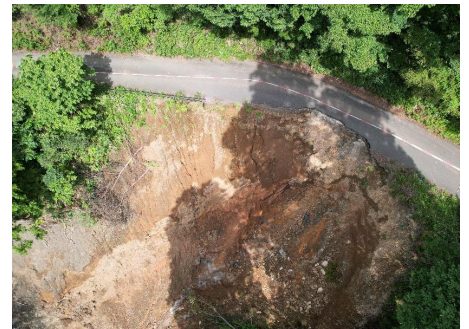
林道の被害状況（仁別林道） (秋田署：秋田県秋田市)
