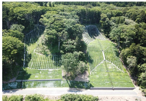
令和3年台風9号による災害の復旧状況 (下北署：青森県風間浦村)
