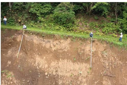
職員による林道の被害状況調査 (米代西部署：秋田県藤里町)
