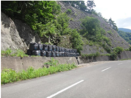
大雨災害時の応急対策として 大型土のうを設置 (岩手南部署：岩手県奥州市)
