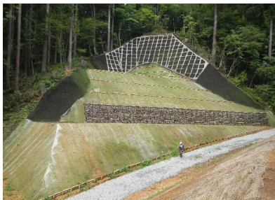
令和5年7月の大雨による災害の復旧状況 (米代西部署：秋田県三種町)
