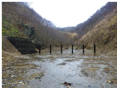
流木対策（独立基礎型流木捕捉工） (金木支署：青森県中泊町)
