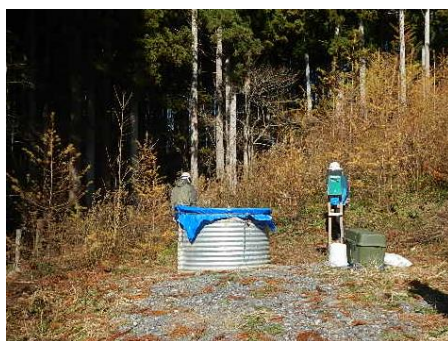
大型排水管を利用した残渣処理設備 （遠野支署：岩手県遠野市）
