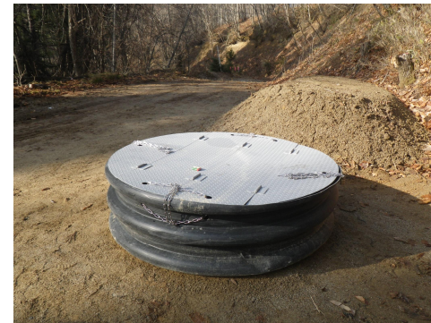
大型排水管を利用した残渣処理設備 (三陸北部署：岩手県宮古市)
