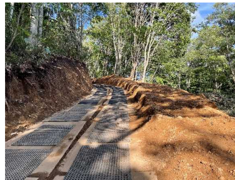
市道が被災し緊急的に迂回路を国有林内に確保 (津軽署：青森県平川市)
