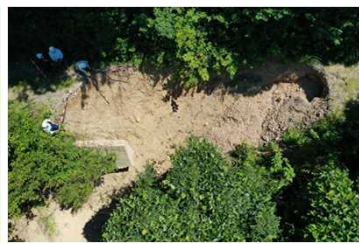
林道崩落被害箇所上空写真 (由利署：秋田県由利本荘市)
