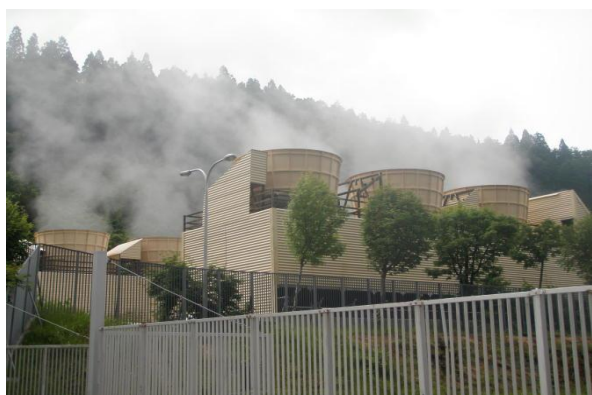
稼働中の上の岱地熱発電所
