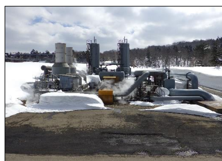
澄川地熱発電所（鹿角市）
