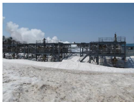
地熱発電所（鹿角市）
