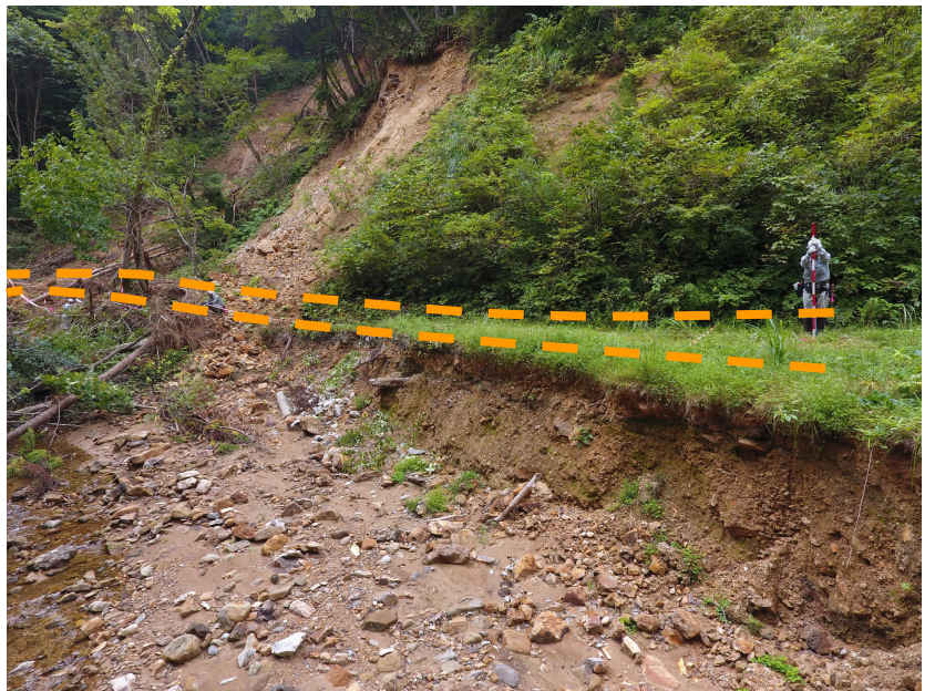
写真8.被災状況（起点側→終点側：箇所④）
