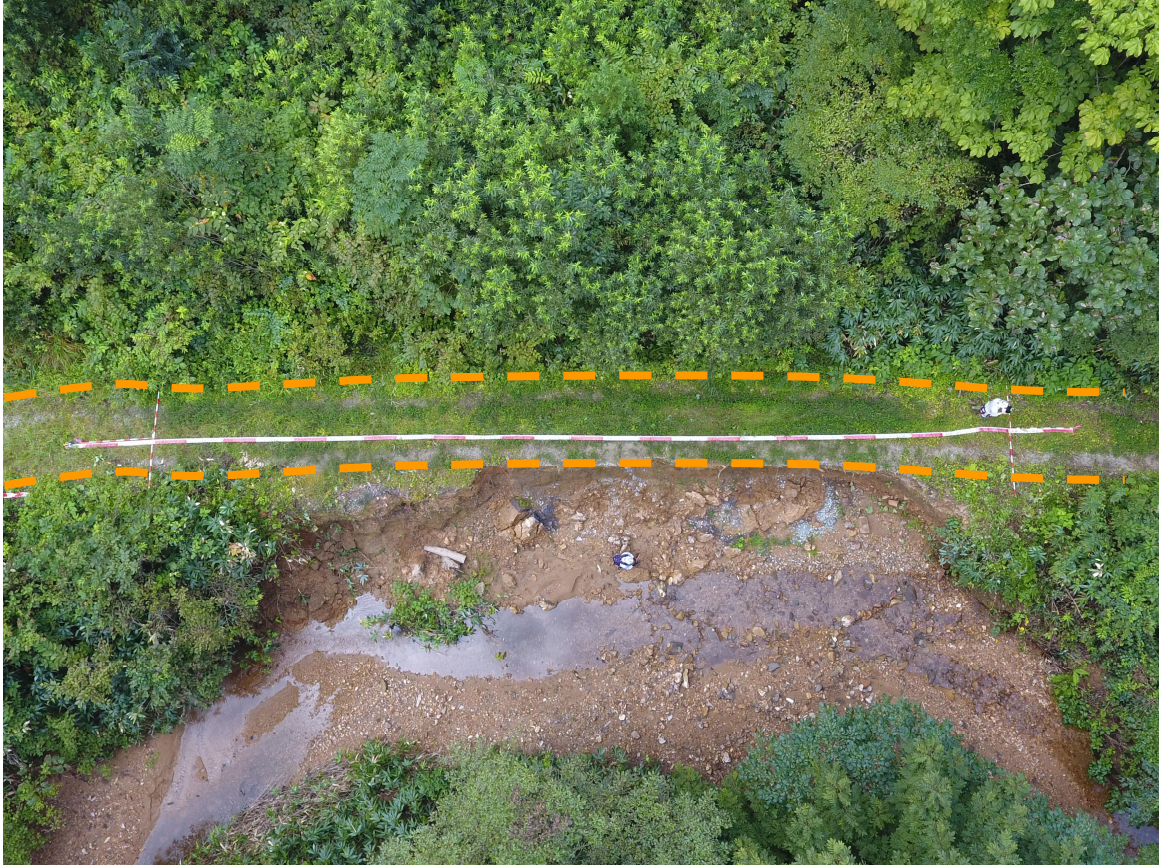
写真3.被災状況（上空から全景：箇所②）
