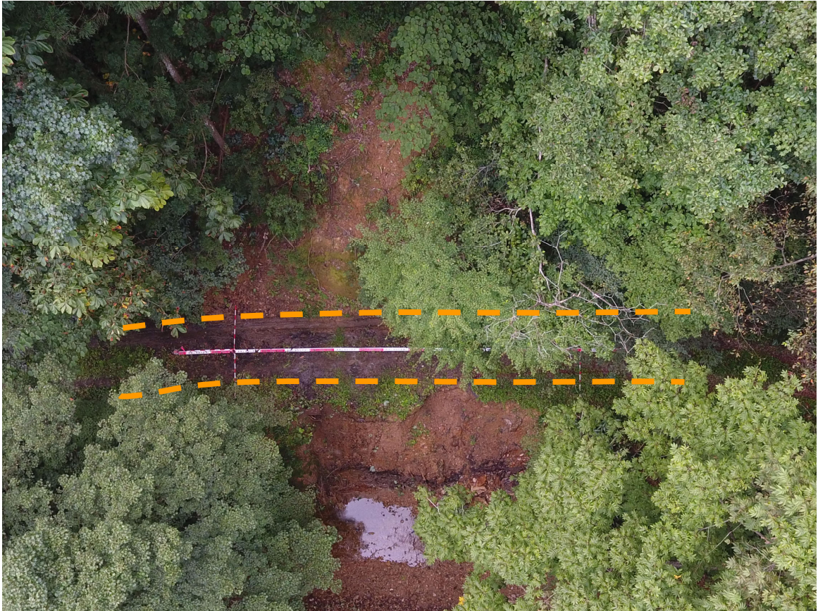
写真1.被災状況（上空から全景：箇所①）
