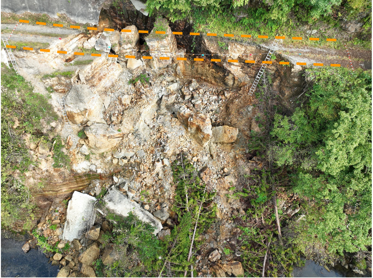
写真1.被災状況（上空から全景）
