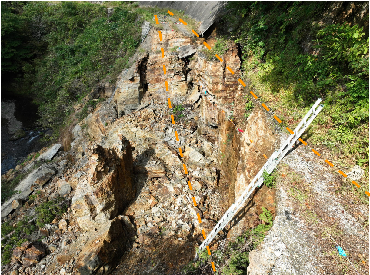
写真2.被災状況（起点側→終点側）
