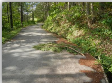
道路の落枝 状況
