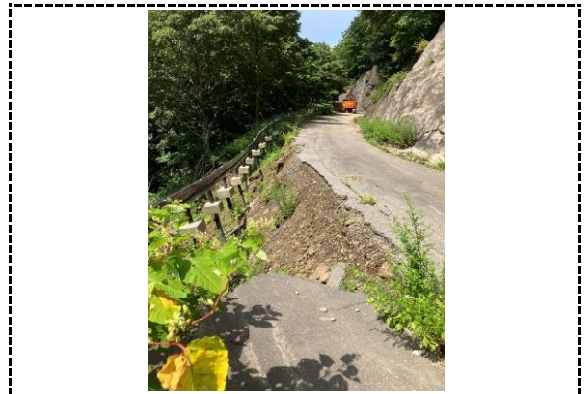
8月15日 白神ライン笹内川崩落地通行状況確認 場所：笹内川上流部
