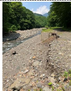
7月10日 追良瀬川築堤管理道崩壊の巡視 場所：追良瀬川上流部
