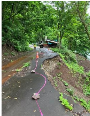
7月10日 赤石溪流線通行状況確認 場所：鯨ヶ沢町道赤石溪流線
