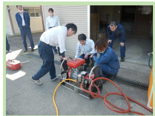
消火ポンプの点検
