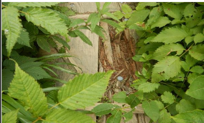
大黒天の木道が一部壊れていました。 足元に気を付けてご通行ください。
