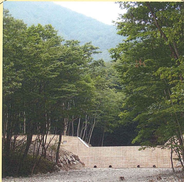
堤長41m、堤高5.5m、堤体底巾3.65m、木材使用量79m 3 の治山ダム(H21年完成)
