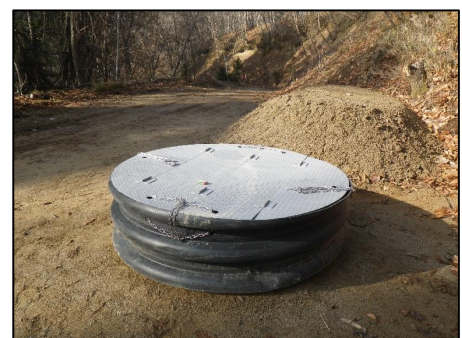
大型排水管を利用した残渣処理施設
