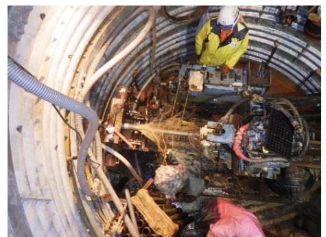
地すべり防止工 (集水井) (十和田市)
