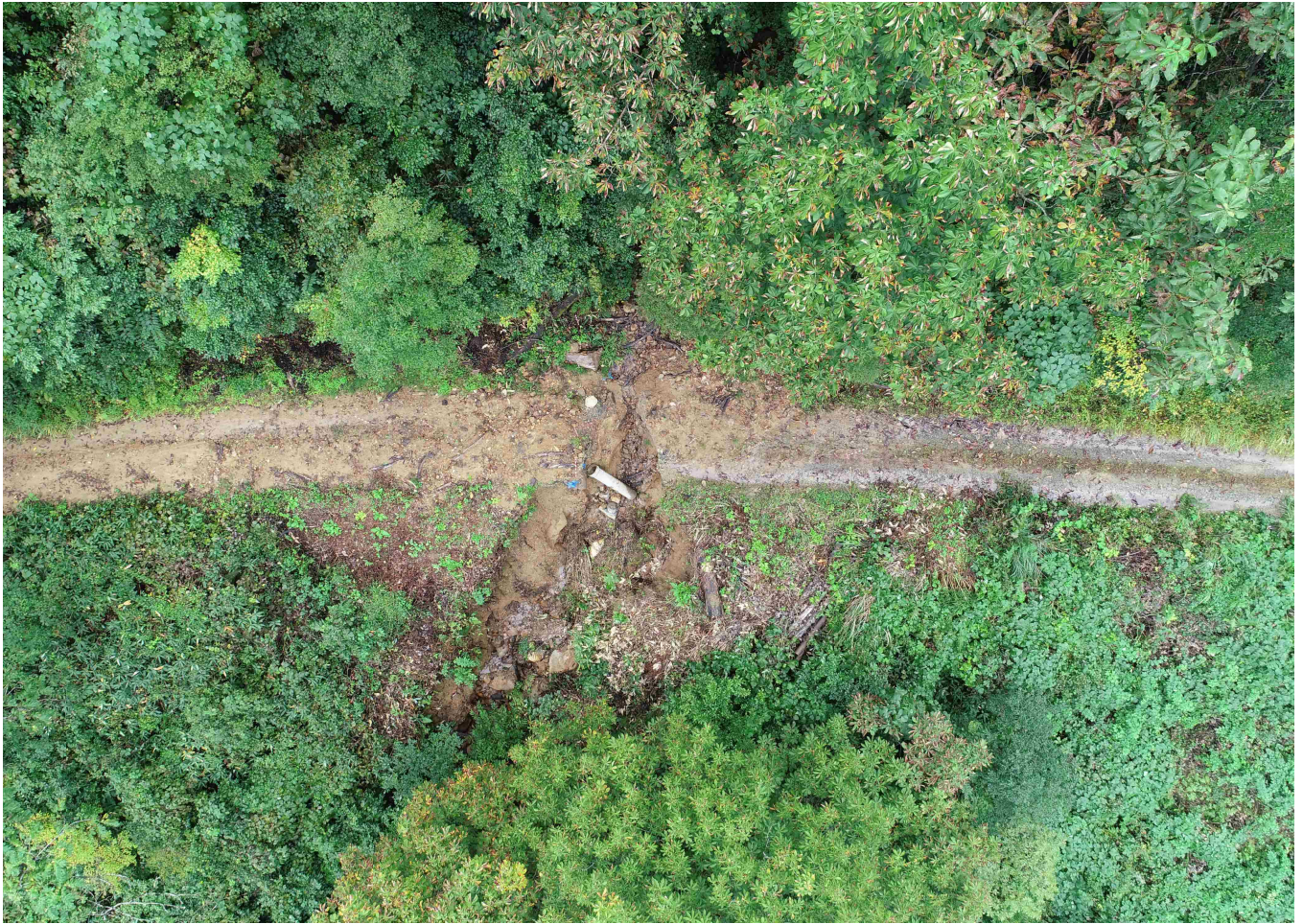
10-4 0.8km 路肩崩落 L=16m
