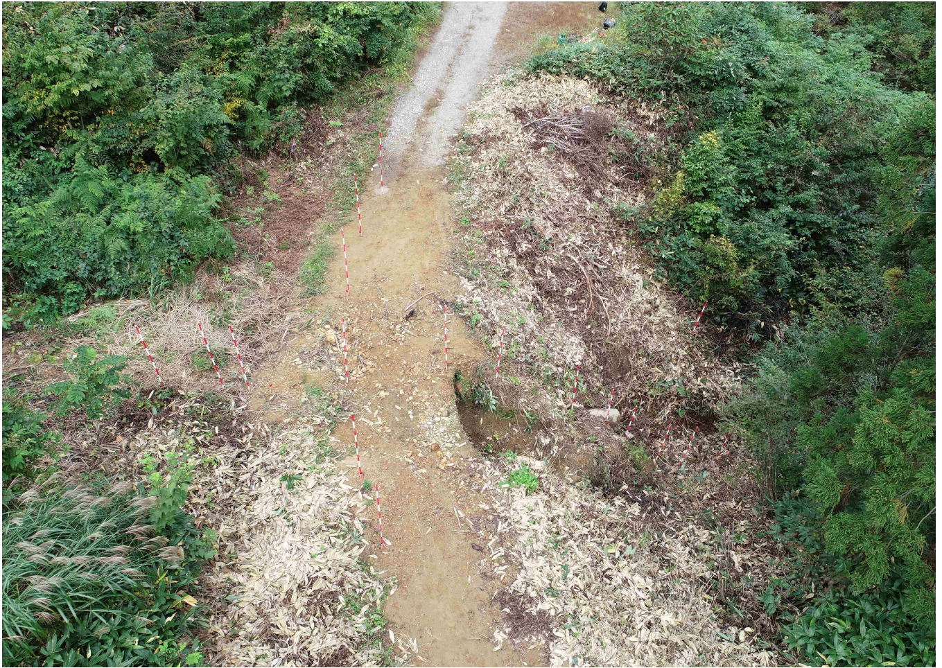
10-7 1.6km 路肩損壞 L=16m
