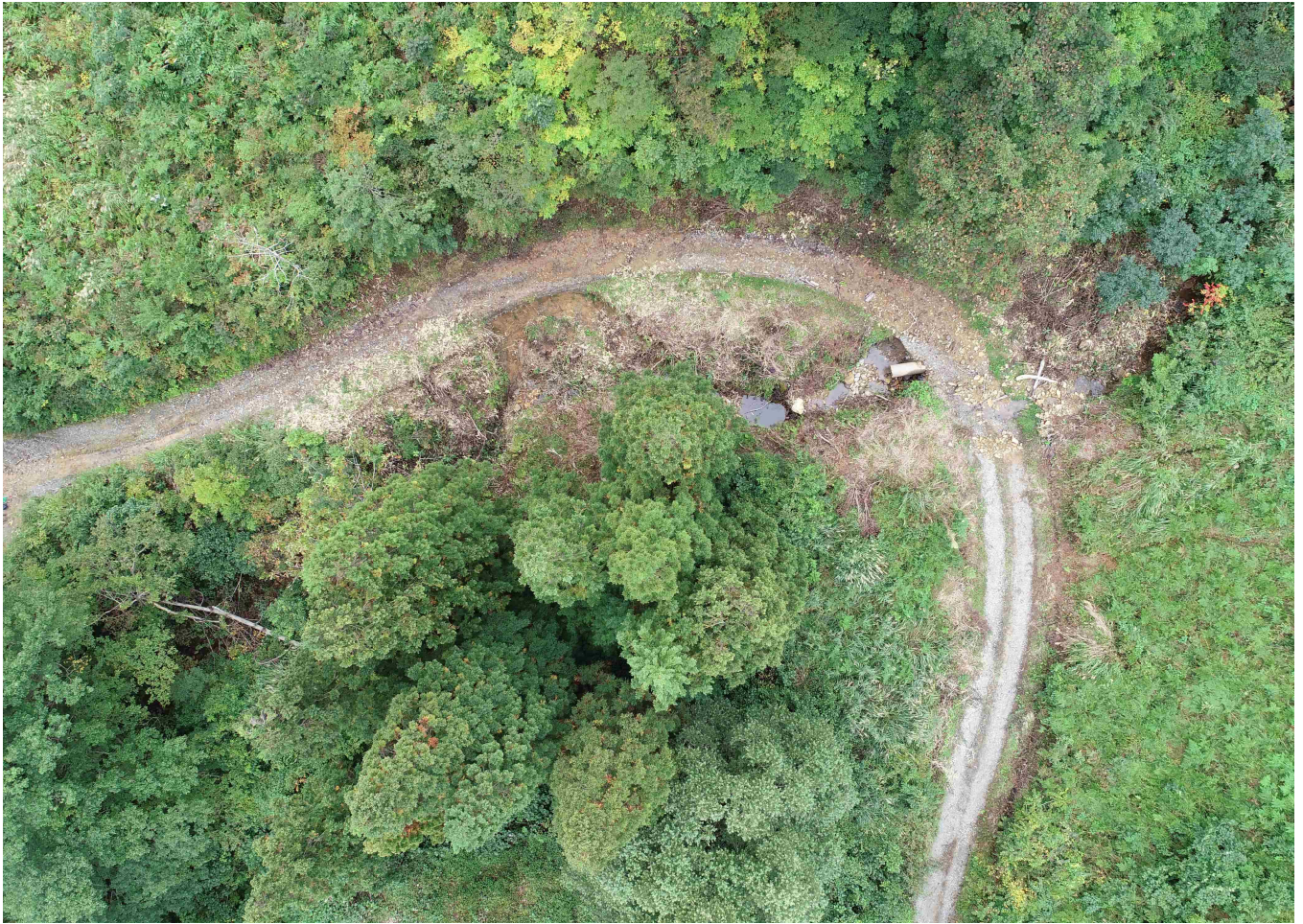
10-5 1.1km 路肩崩壊ほか L=53m
