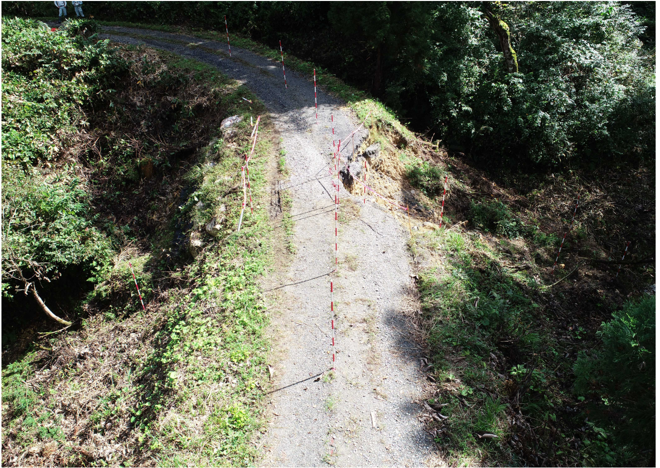
18-1 0.8km 路肩崩落 L=22m
