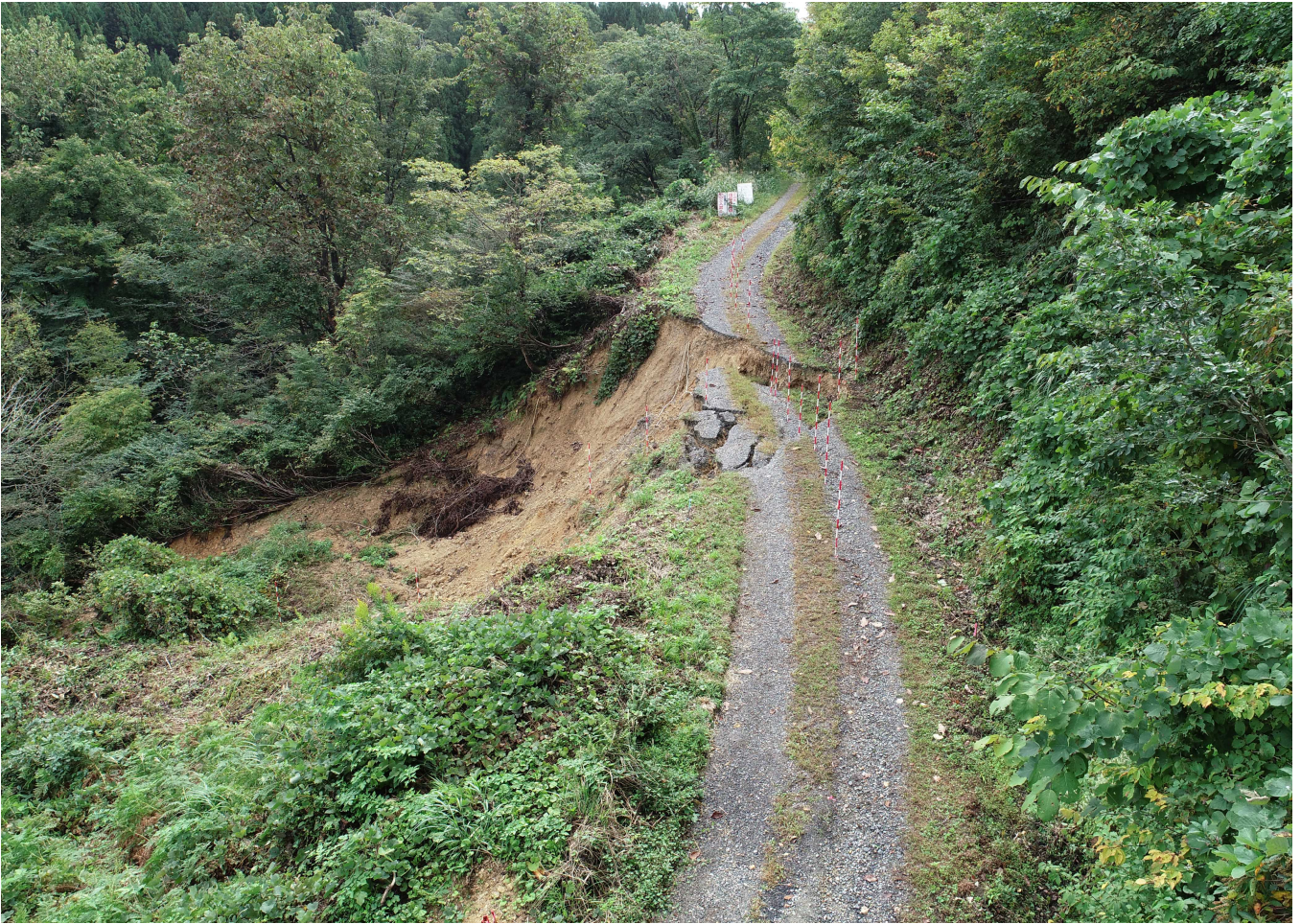
18-3 1.7km 路肩決壊 L=30m
