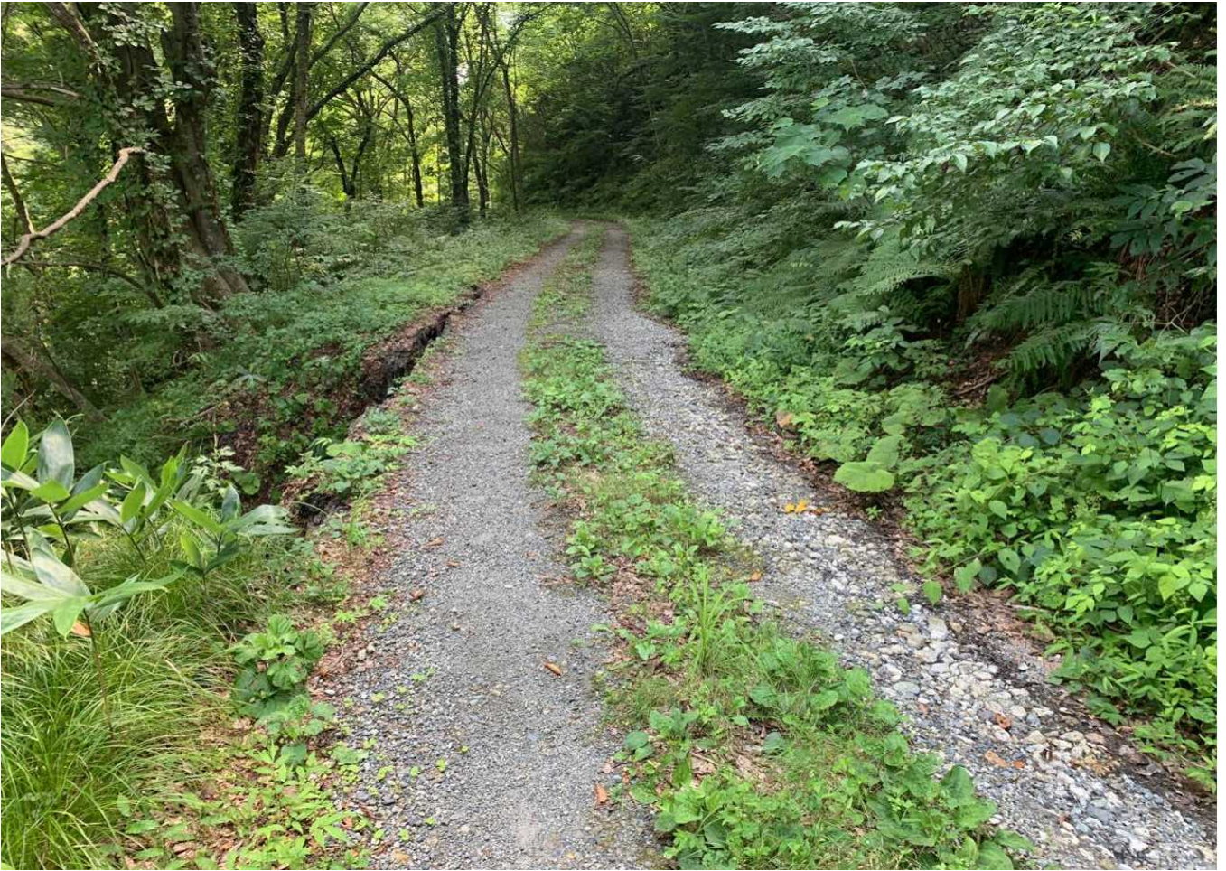
9-4 0.8km 路肩崩落 L=10m
