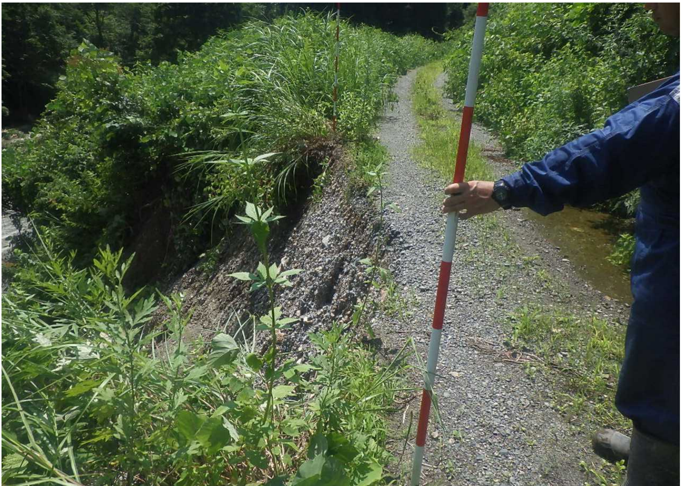
9-5 1.1km 路肩崩落 L=10m
