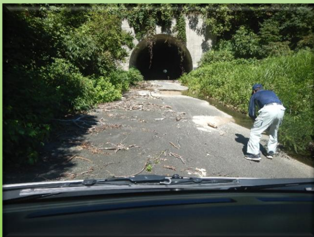
降雨後の路上に散在する枝条除去
