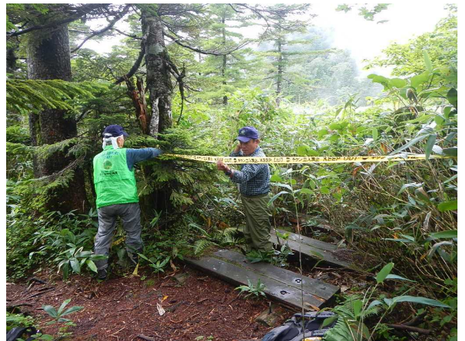
危険箇所に立入禁止テープ設置するスタッフ
