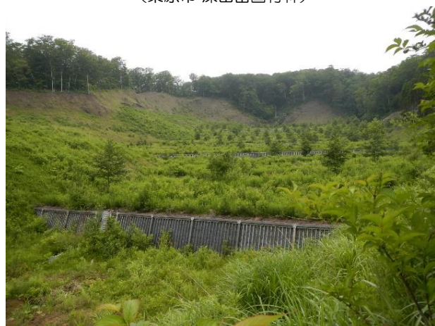
山腹崩壊地を復旧整備する山腹工 (栗原市 深山岳国有林)
