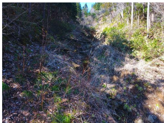
被災状況（R2年4月）
