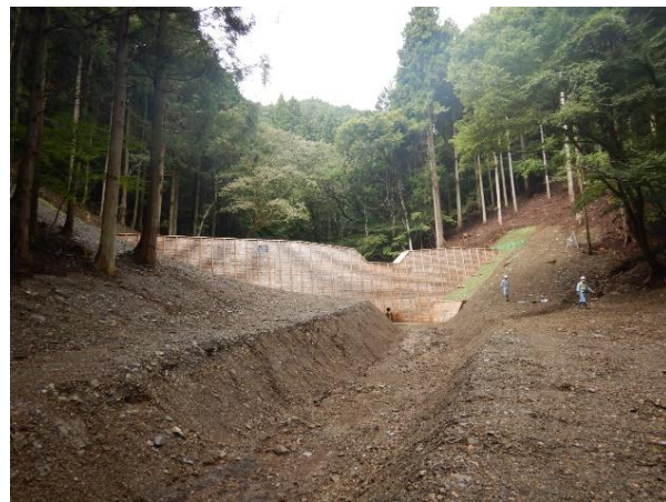
溪床・溪岸を安定化する谷止工 (石巻市 沢釜山国有林)
