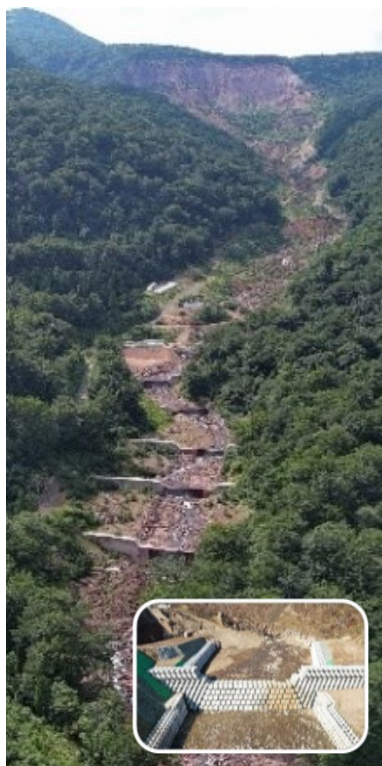
大規模崩壊地（産女川治山工事）
