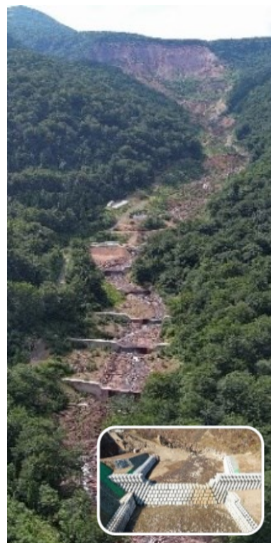
大規模崩壊地（産女川治山工事）
