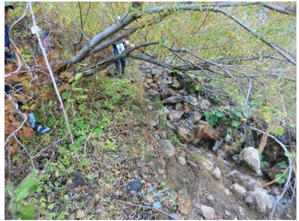
小岳林道終点崩落状況
