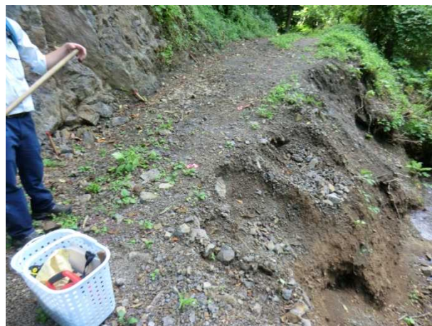
路肩決壊(小入川林道)
