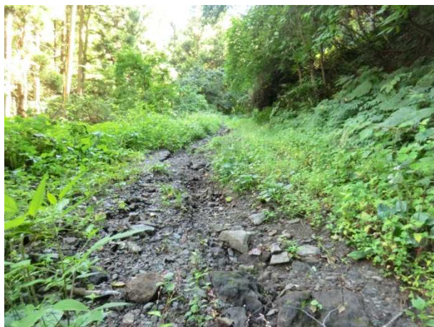
路面洗掘(日陰沢林道)
