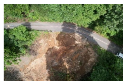
2.7km地点 道路側面崩落 L=35.5m
