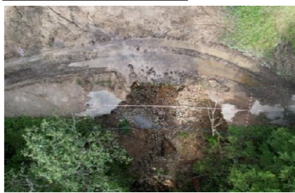
8.9km地点 道路崩壊 L=17.0m
