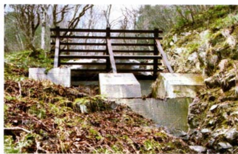
コンクリートと鋼材で作られた なだれ予防柵
