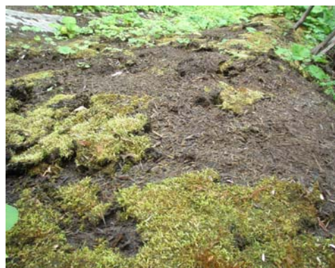
図-6 施行地内で確認された基盤材の剥離
