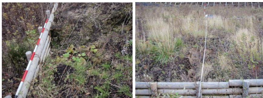
写真-2 配置間隔の施工効果(異常の発生状況)
