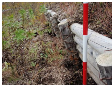
写真-3 柵高の施工効果(異常の発生状況)
