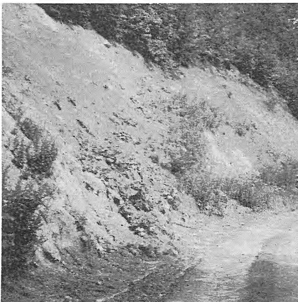
(写-9) 切取法面の崩落
