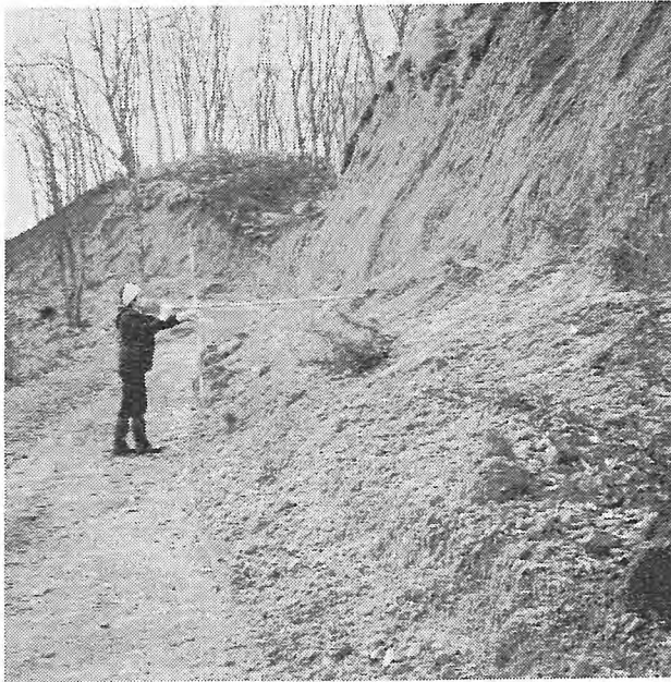
(写-7) 切取法面の崩壊、延長75、0 m
