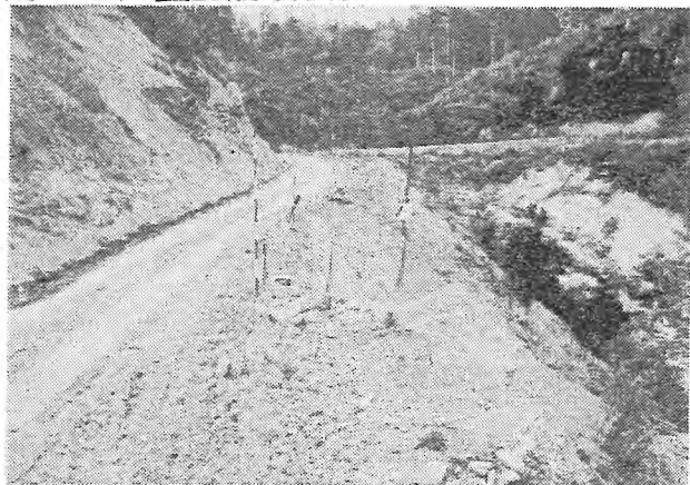
(写-2) 盛土崩壊状況
