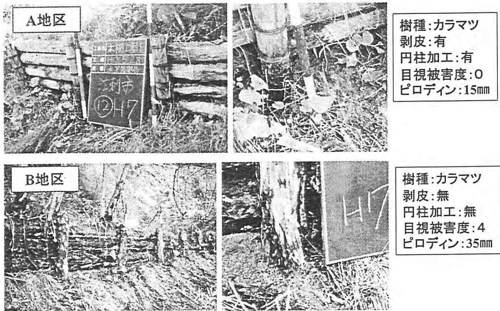
写真-3 木材の腐朽状況(経過6年目)
