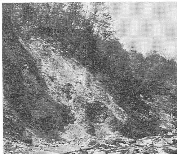
写-4 溪岸崩壊の状況
