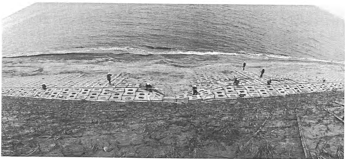
写-6 ブロック沈下被害状況
