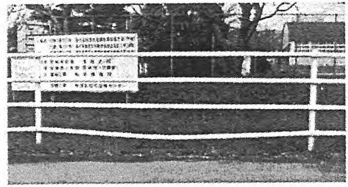
写真 8 最下段ビームの変形状況
