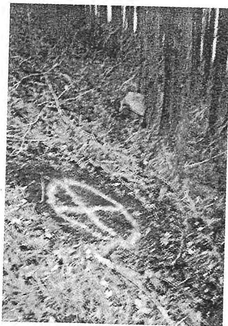
写-1 落石危険箇所の表示
