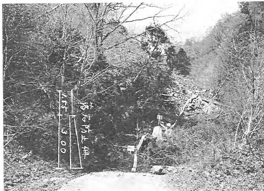
(写真3) 法面崩壊 金木宮林署 内瀉林道
