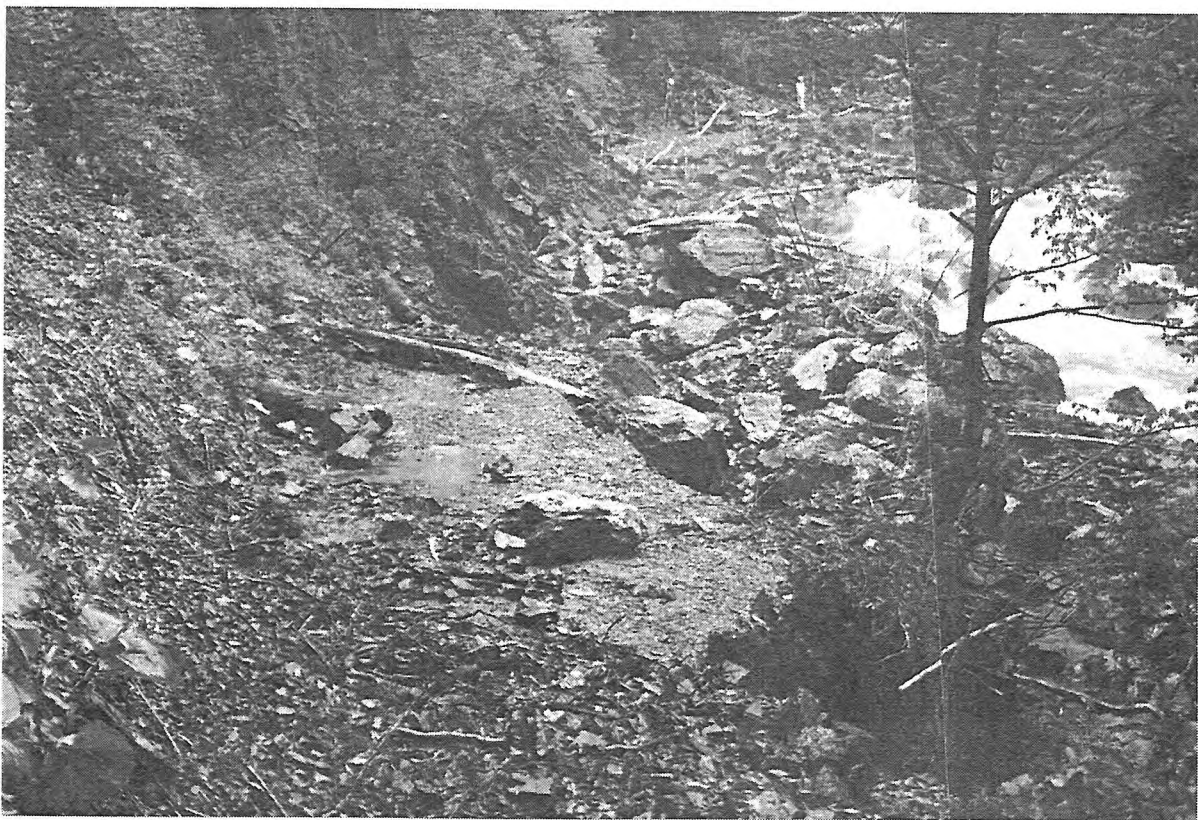
(写真2) 路体流失 弘前営林署 大沢林道
