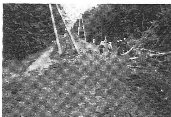
写-2 市道被災状況
