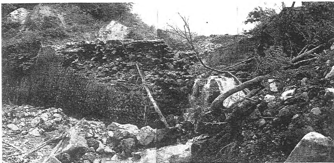
決壊したNo.2堰堤
