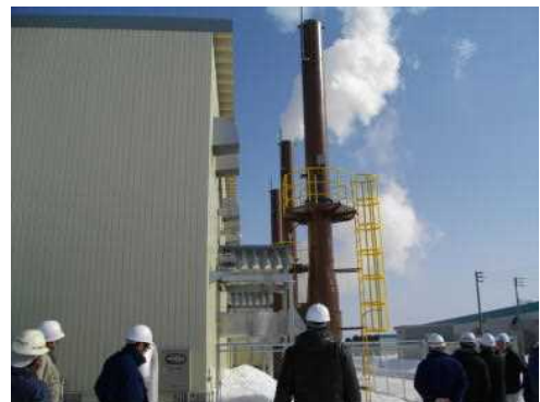
民間工場チップボイラー稼働
