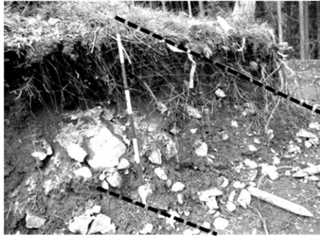
写真1 網下空き破損(地盤崩れによる)
