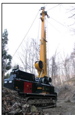
図3 タワーヤード
