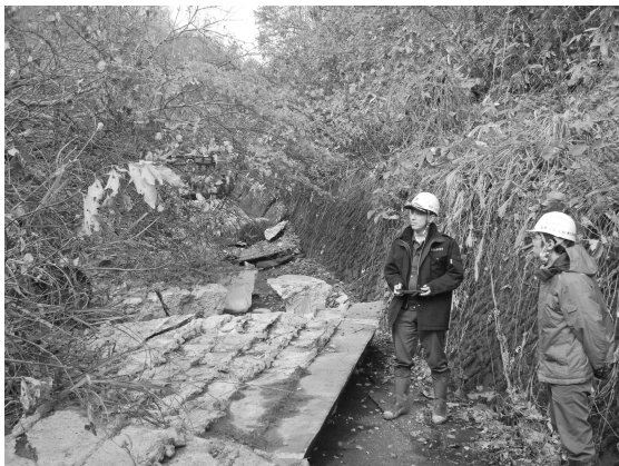
写真 6 UAV による被災状況の確認
