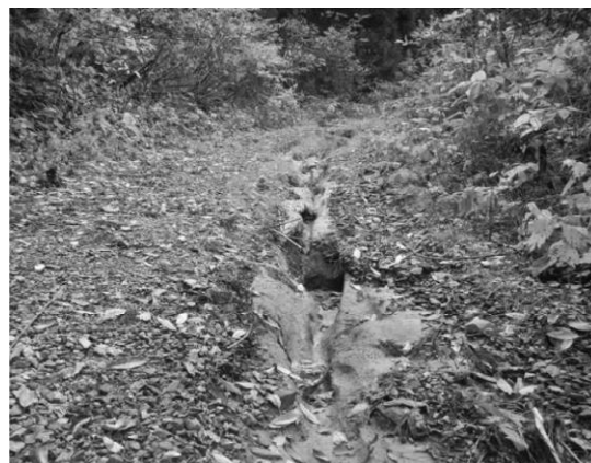
図 1 洗掘された林道の例
