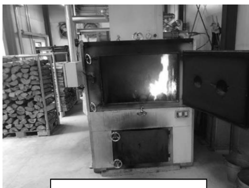
加温用薪ボイラー
